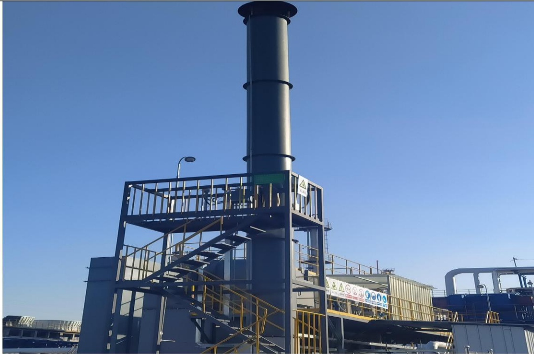
本项目排气筒采样平台
