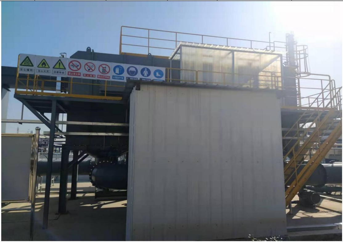
废气处理设施（RTO）
